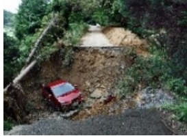
深さ5m長さ20m 桑野地区市道の崩落現場
